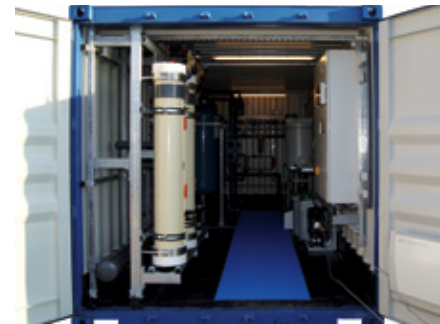
■ Komplett montierte Containeranlage
