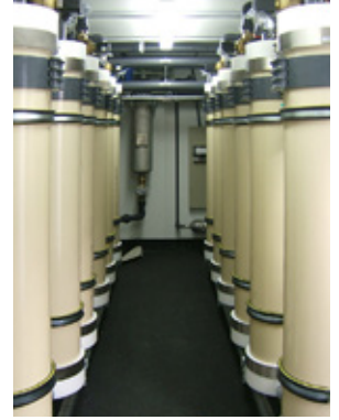
■ Großanlage für Gemeindewasserversorgung
