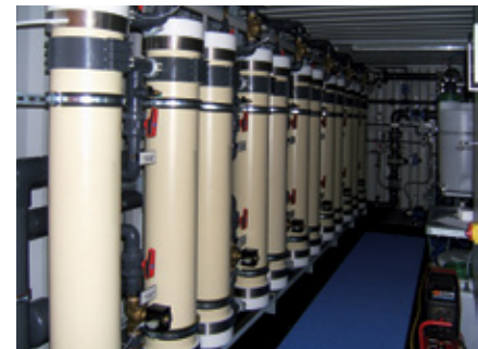
■ Filtrationsmodule in einer Containeranlage
